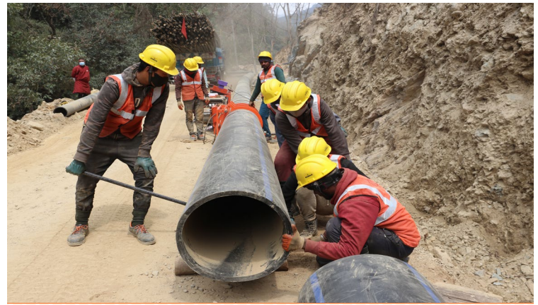
Los trabajadores en Bhután abordan la escasez de agua en Phangyul con la instalación de un sistema de riego por tuberías presurizadas que fue reconvertido con tecnología nueva y resistente al clima. El nuevo sistema de riego beneficiará a 24 pueblos y a más de 1300 acres de tierras agrícolas.
